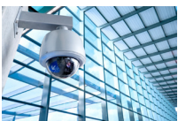
Auditoría Seguridad física Control de accesos, CCTV, alarmas, videovigilancia
